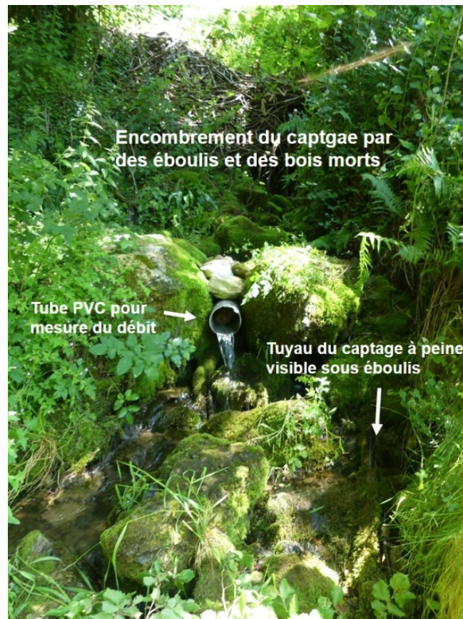
Figure 3 : Photographie du captage de Riou-Sourd dans son état actuel, recouvert par des éboulis et blocs calcaires
