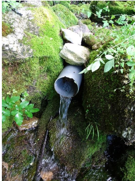
Illustration 13: Cliché du tube PVC destiné à mesurer le débit
